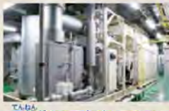
天然ガスコージェネレーション
