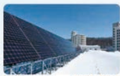
太陽光パネル(みなみの杜高等支援学校)
